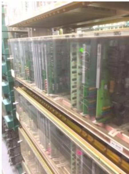
Abbildung 1 Rechenwerk in der Zentrale
